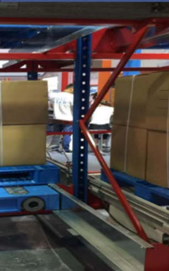
TRANSELEVADOR + SHUTTLE DE CUATRO VÍAS, ALMACÉN AUTOMATIZADO
